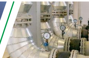
Ventiladores de recuperação de energia
