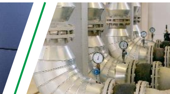
Ventiladores de recuperação de energia
